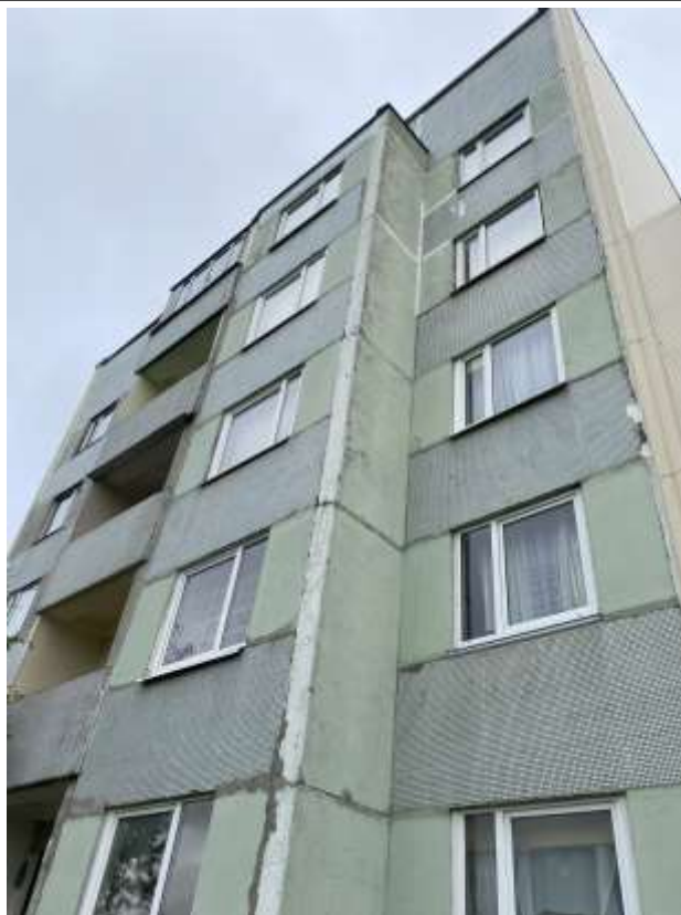
4.2.5.att. Sala, mitruma piesātinājuma bojājumi
