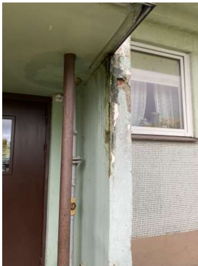
4.9.8.att. Ieejas jumtiņa konstrukcija nepieciešams atjaunot jumta segumu
