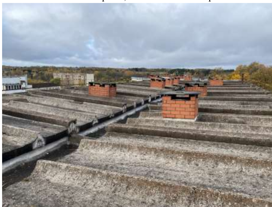
4.8.3.att. Mitruma un sala ietekmē bojāti jumta klāja elementi, atsegts un korodējis stiegorjums
