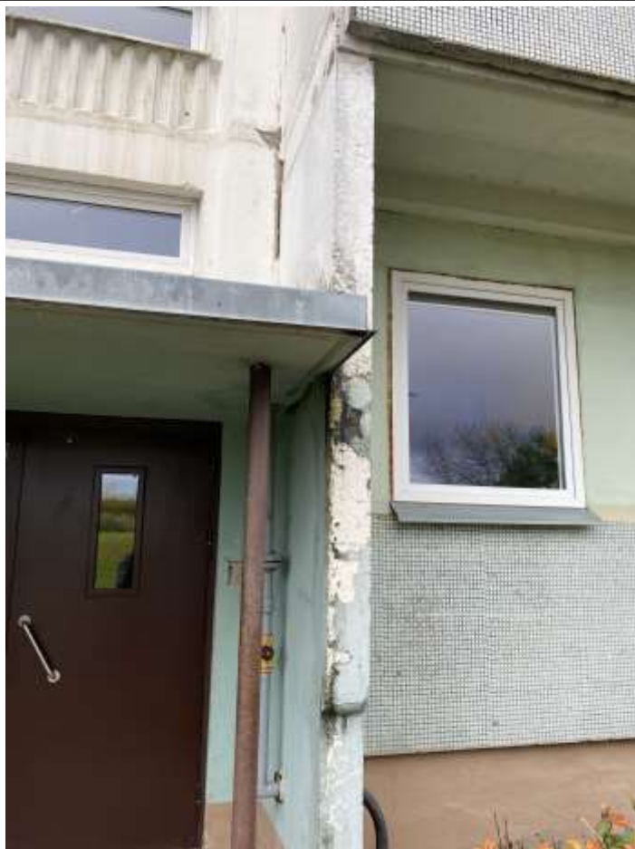
4.2.1.att. Saliekamā dzelzsbetona siena ar lokāliem mitruma bojājumiem.
