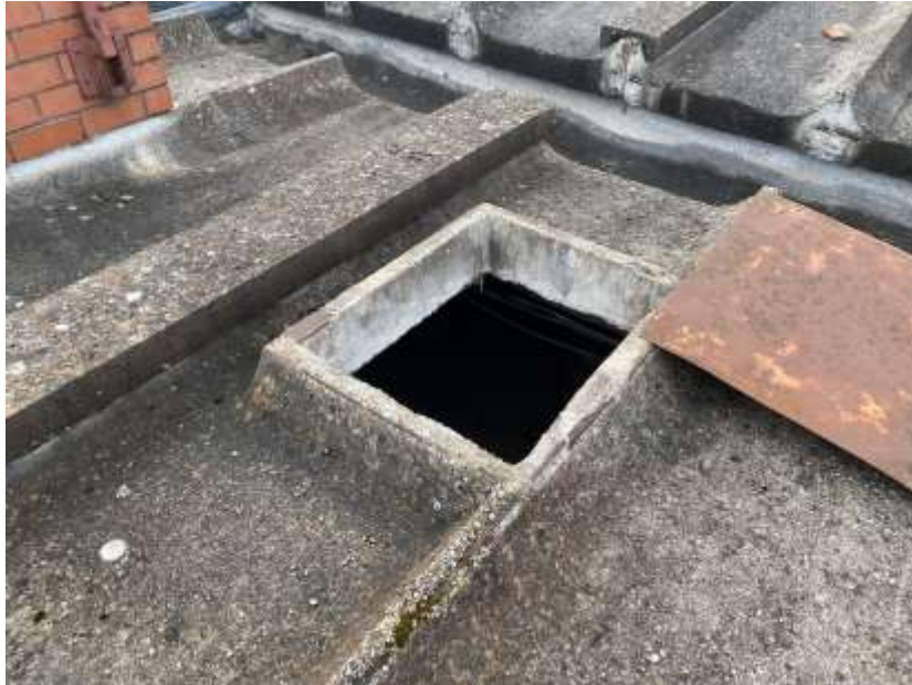
4.8.5.att. Jumta lūka, mitruma un sala ietekmē bojāti jumta klāja elementi, atsegts un korodējis stiegorjums
