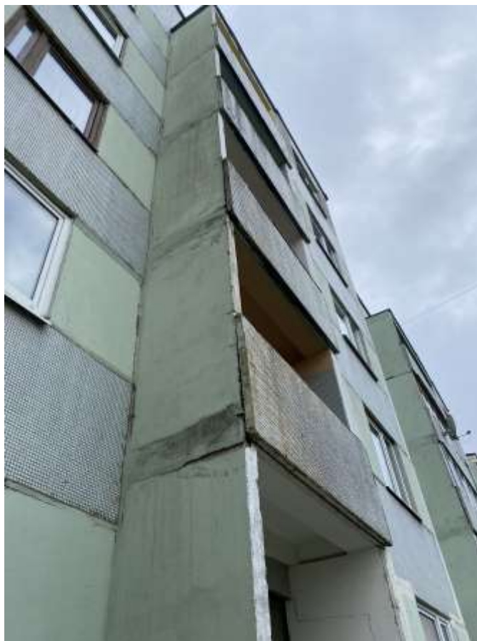
4.5.2.att. Sienas paneļu bojājumi, ar javu veikts remonts
