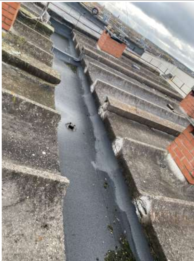
4.8.6.att. Mitruma un sala ietekmē bojāti jumta klāja elementi, atsegts un korodējis stiegorjums
