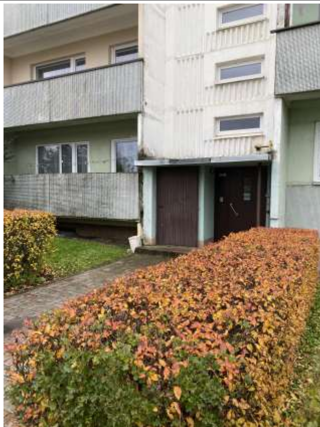
4.9.7.att. Ieejas jumtiņa konstrukcija nepieciešams atjaunot jumta segumu
