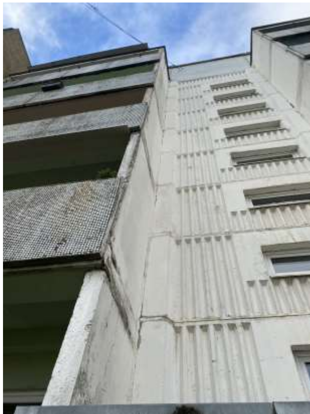
4.2.2.att. Sala, mitruma piesātinājuma bojājumi, bioloģiskais apaugums
