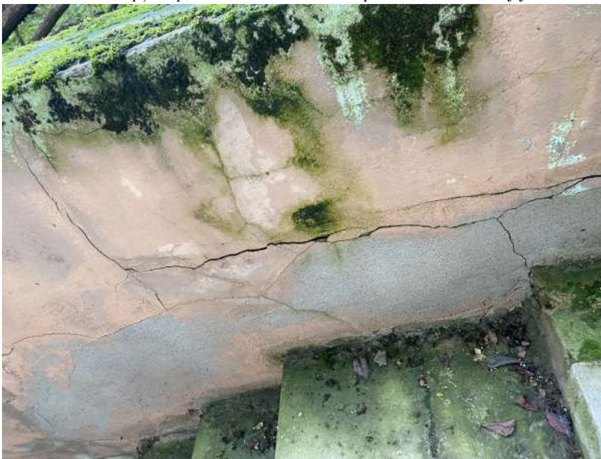
4.2.8.att. Bojātā atbalstu sienas konstrukcija
