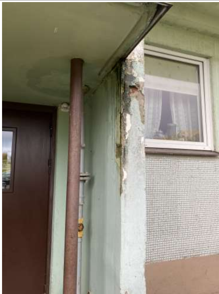
4.2.3.att. Sala, mitruma piesātinājuma bojājumi, bioloģiskais apaugums
