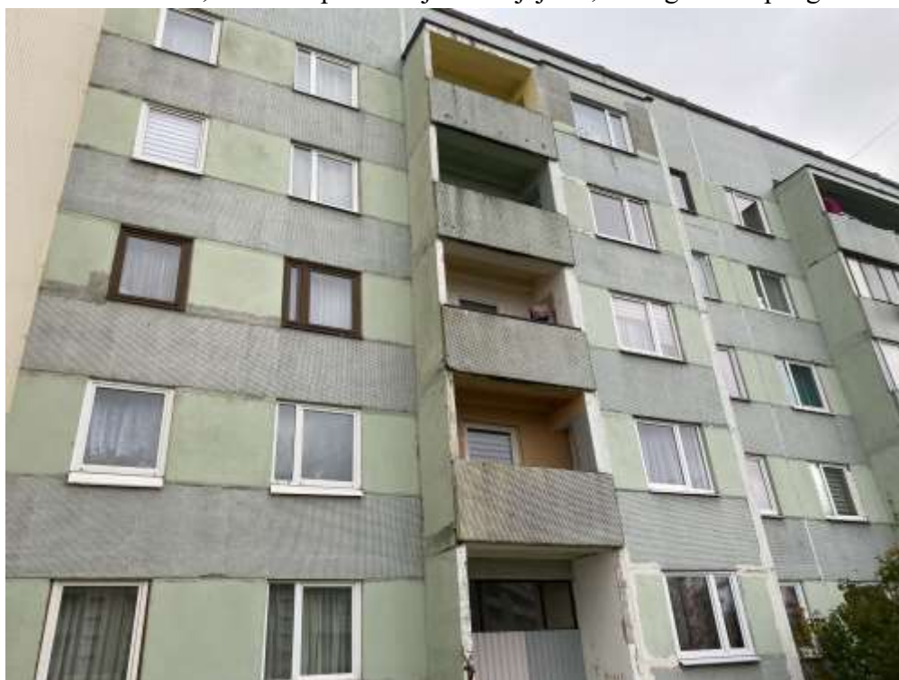
4.2.4.att. Sala, mitruma piesātinājuma bojājumi
