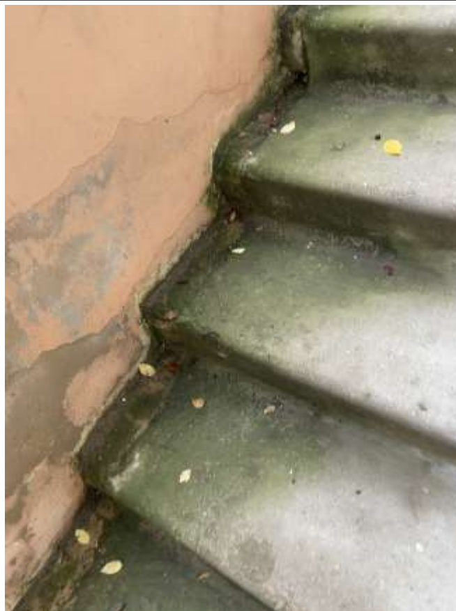
4.10.2.att. Dzelzsbetona konstrukciju pagraba kāpnes ar lokāliem mitruma bojājumiem
