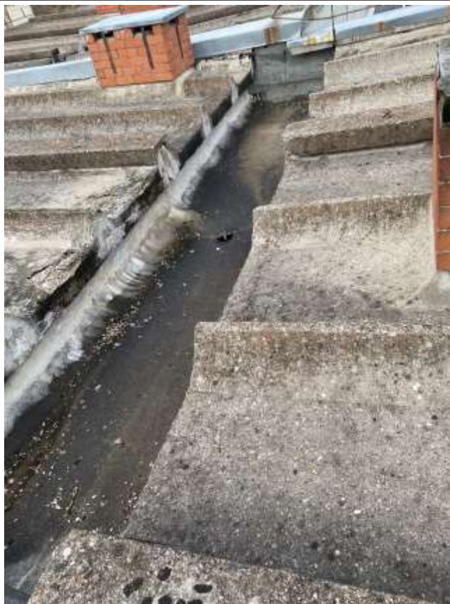
4.8.8.att. Mitruma un sala ietekmē bojāti jumta klāja elementi, atsegts un korodējis stiegorjums
