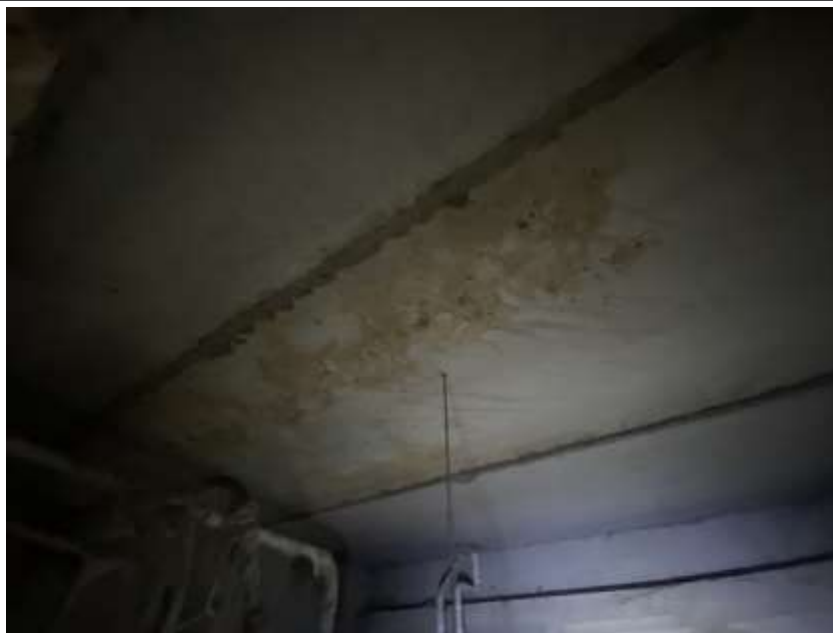
4.6.2.att. Pagraba stāva pārsegums, mitruma defekti
