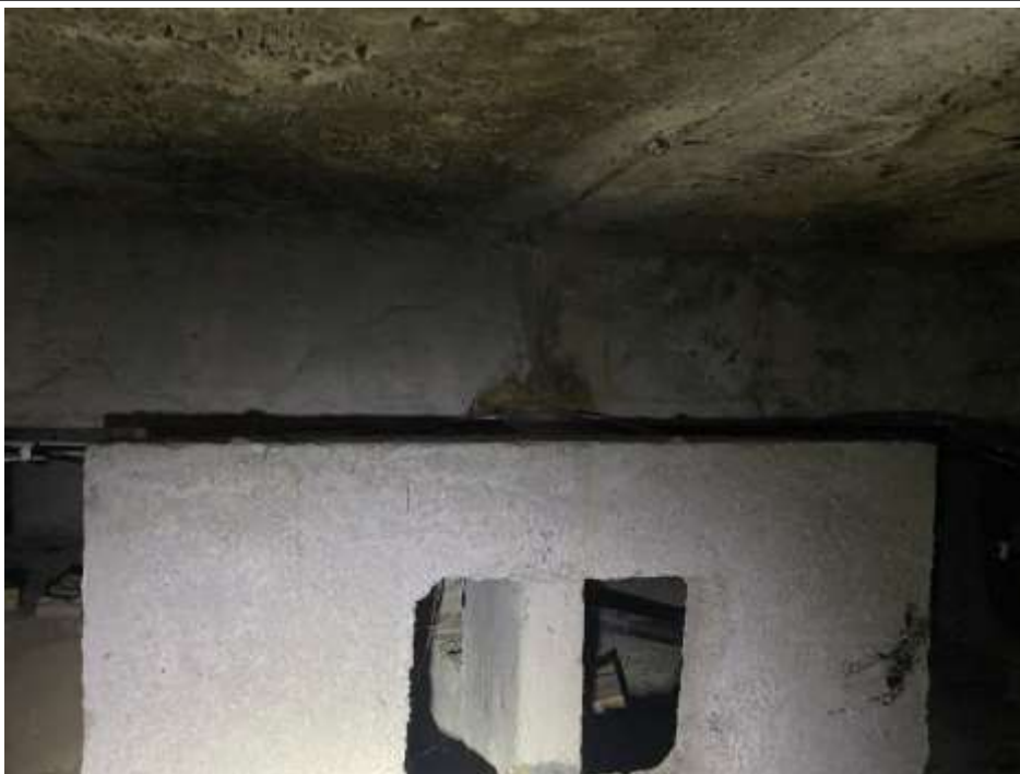
4.8.2.att. Jumta nesošais elements – trapecveida jumta panelis. Uz jumta ribotās plātnes var redzēt mitruma pēdas, nelielus betona izdrupumus.
