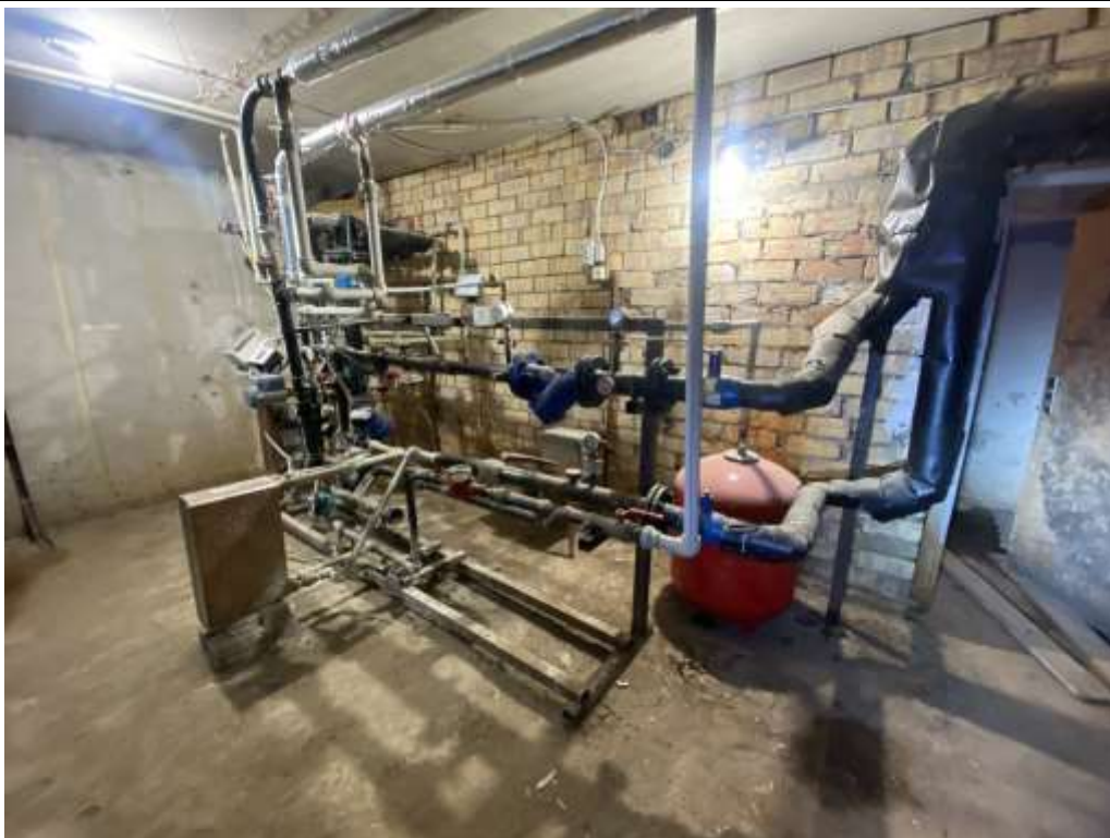
5.4.1. att. Automatizētais individuālais siltummezgls
