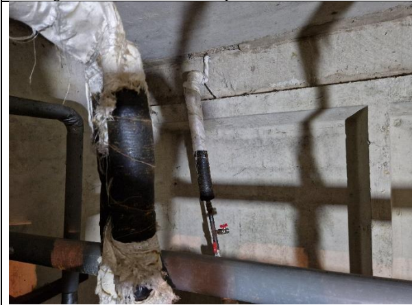
6.att. Apkures cauruļvadu siltumizolācija sliktā stāvoklī
