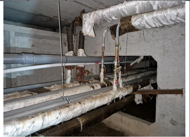
7.att. Karstā ūdens cauruļvadu siltumizolācija sliktā stāvoklī
