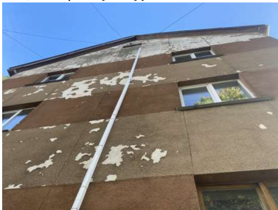
4.2.2.att. Sala, mitruma piesātinājuma bojājumi, bioloģiskais apaugums
