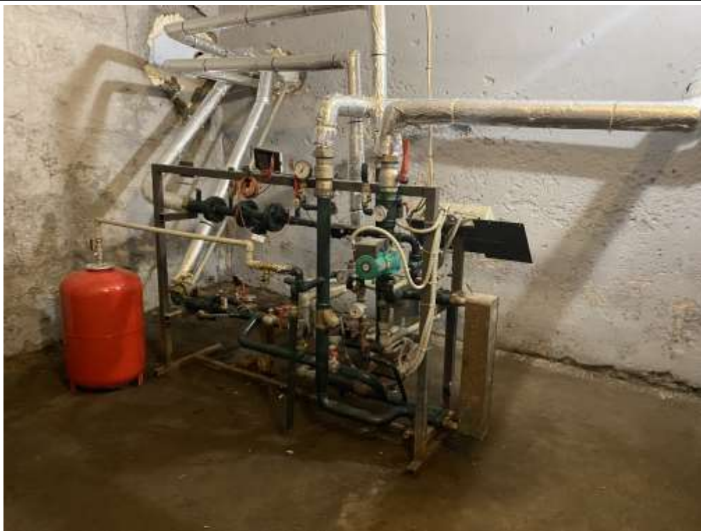
5.4.1. att. Automatizētais individuālais siltummezgls
