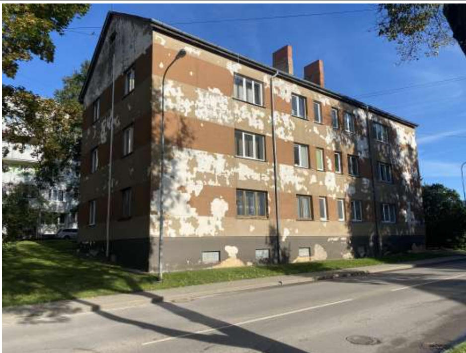
4.2.3.att. Sala, mitruma piesātinājuma bojājumi, bioloģiskais apaugums
