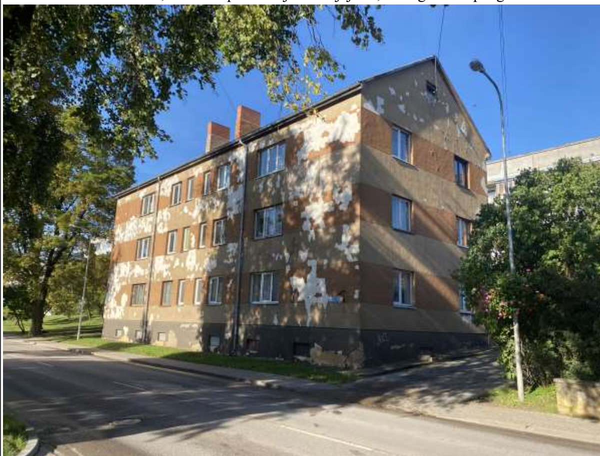
4.2.4.att. Sala, mitruma piesātinājuma bojājumi
