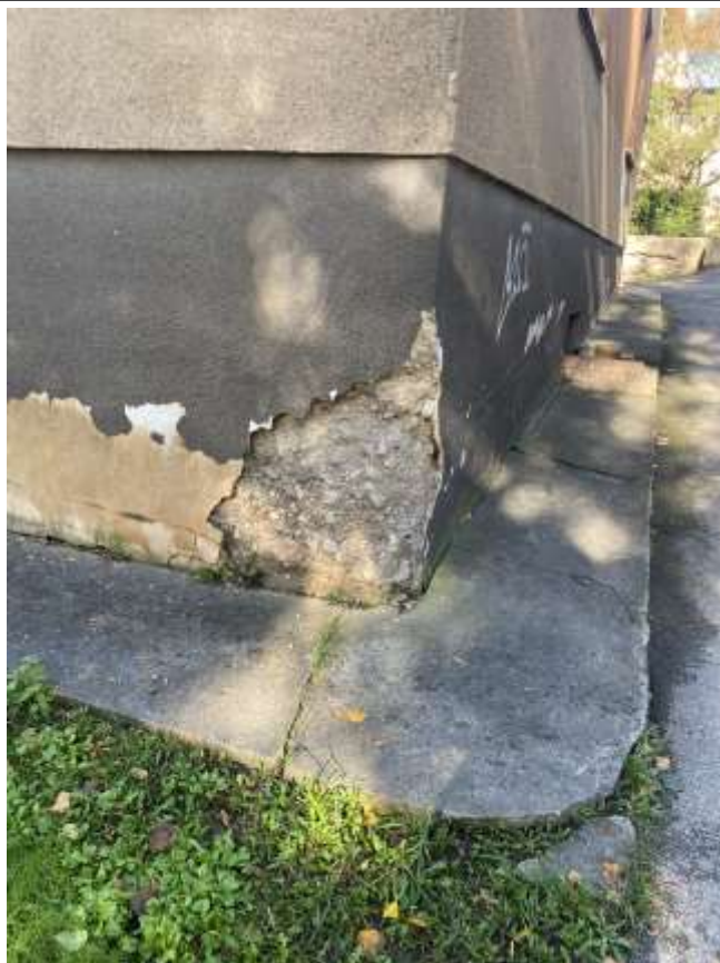
4.1.1. att. Apmetuma erozija ēkas cokola daļā
