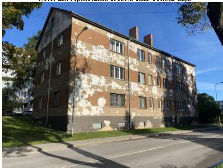
4.1.2. att. Apmetuma erozija ēkas cokola daļā
