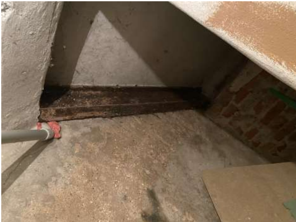
4.10.3.att. Dzelzsbetona konstrukciju pagraba kāpnes, U tipa sijas vajadzīgs apstrādāt ar pretkorozijas krāsojumu.
